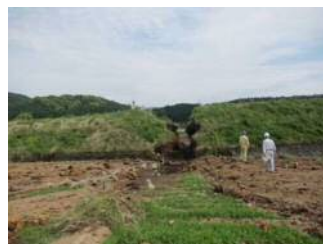
堤体の損傷箇所(農地側から)
