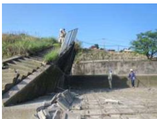
洪水吐側壁の傾倒
