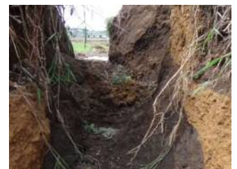
決壊部(池側から)
