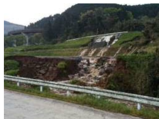
下流分水工の損壊(被災直後の漏水)
