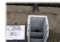
排水樹の整備
