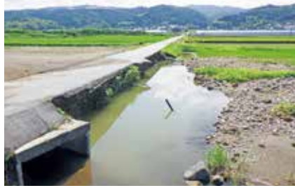
被害状況(道路法面崩壊)
