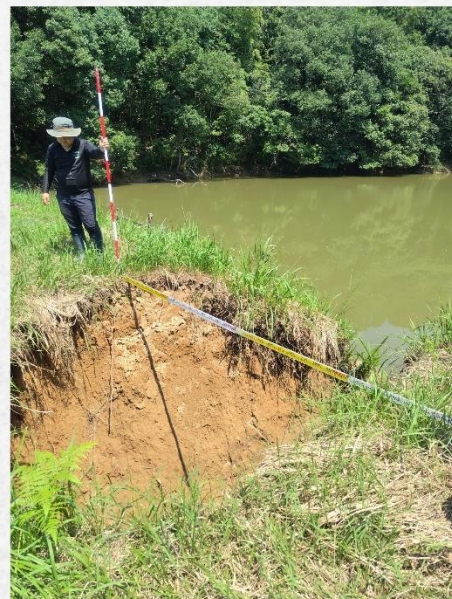
▲被災状況調査
