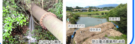
パイプ化漏水
