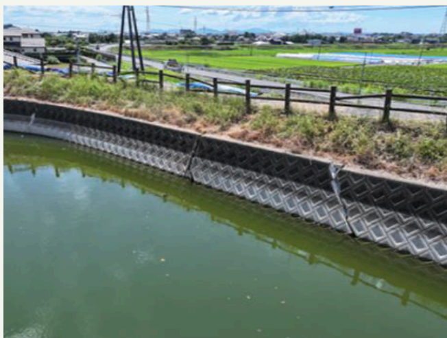
▲ため池堤体のクラック (宇城市・高倉)
