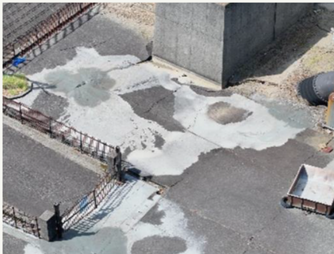
▲排水機場の液状化 (八代市・昭和第2排水機場)
