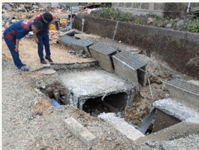
▲幹線水路の損壊 (氷川町・氷川幹線水路)
