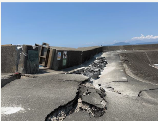
▲海岸堤防の損壊 (八代市・昭和海岸)
