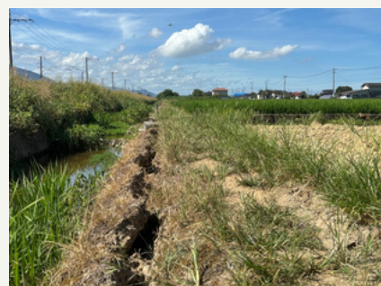
▲排水路部クラック
