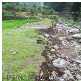
被害状況（農地法面崩壊）
